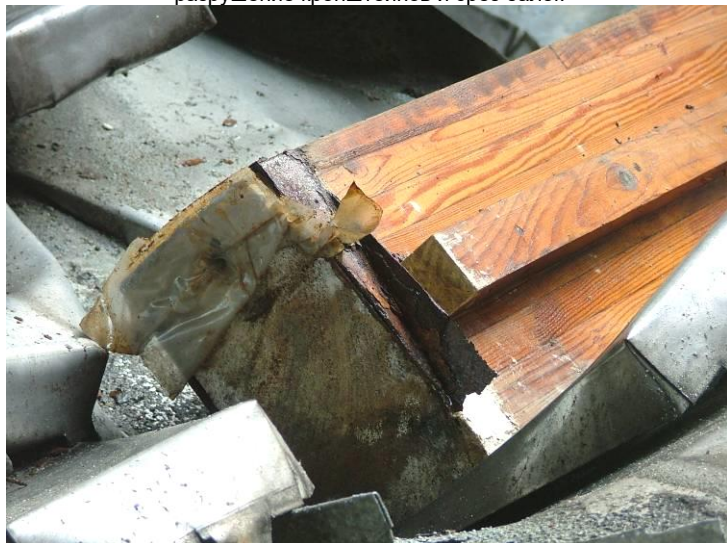
Рисунок 9.11 – Фрагмент балки покрытия: интенсивная коррозия и полное разрушение кронштейна
