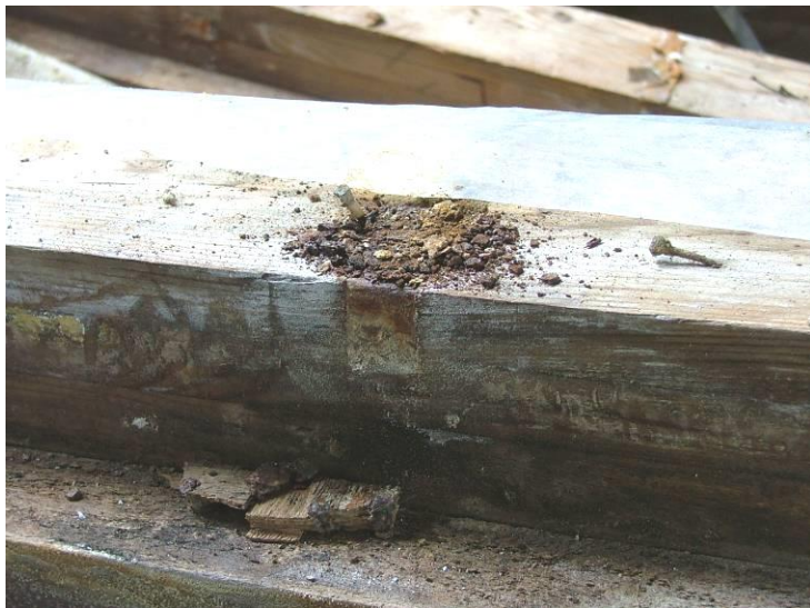
Рисунок 9.13 – Фрагмент балки покрытия и разрушенного коррозией участка обвязки
