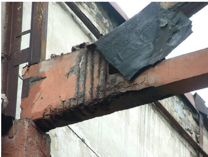
Рисунок 9.2 – Фрагмент участка опирания фермы: оголение и пластинчатая коррозия хомутов; отдельных участков конструктивной и рабочей арматуры; разрушение бетона защитного слоя
