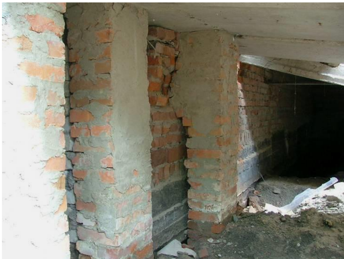
Рисунок 9.25 – Дополнительные столбы из кирпича керамического полнотелого: отсутствие анкеровки столбов к стенам
