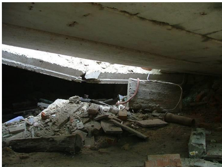
Рисунок 9.24 – Фрагмент участка перекрытия технического подполья: смещение плит; излом и разрушение участка плиты перекрытия
