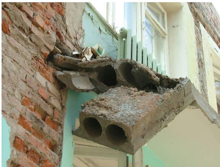
Рисунок 9.19 – Общий вид участка обрушения: излом и полное разрушение отдельного участка плиты
