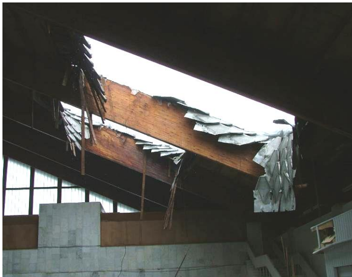
Рисунок 9.9 – Фрагмент участка обрушения (вид снизу): обрушение и полное разрушение двух участков покрытия
