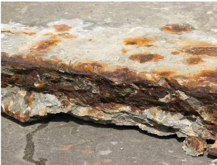
Рисунок 9.37 – Фрагмент балконной плиты: полное разрушение арматурных стержней коррозией
