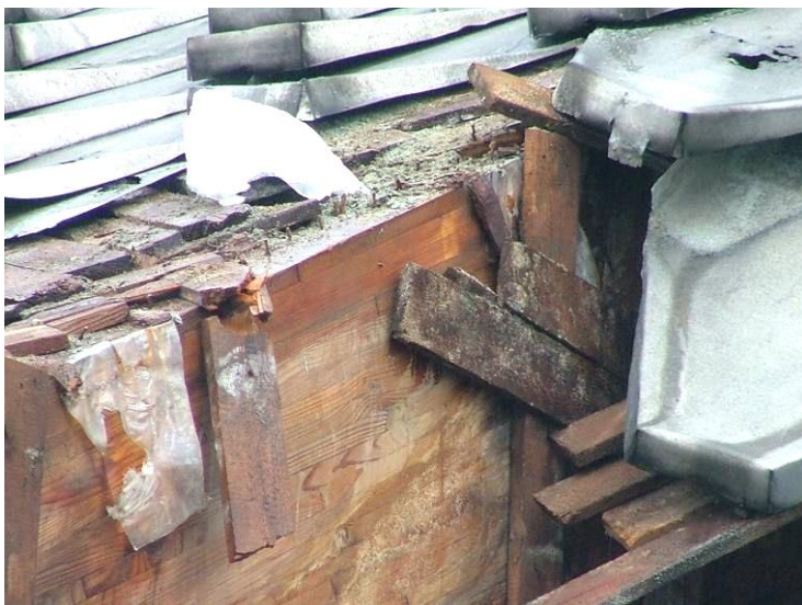
Рисунок 9.10 – Фрагмент покрытия на участке обрушения (вид сверху): разрушение кронштейнов и срез балок
