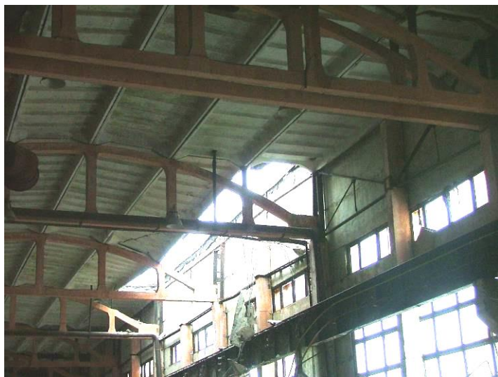
Рисунок 9.1 – Фрагмент общего вида цеха изнутри на участке обрушения: обрушение и полное разрушение двух крайних плит покрытия
