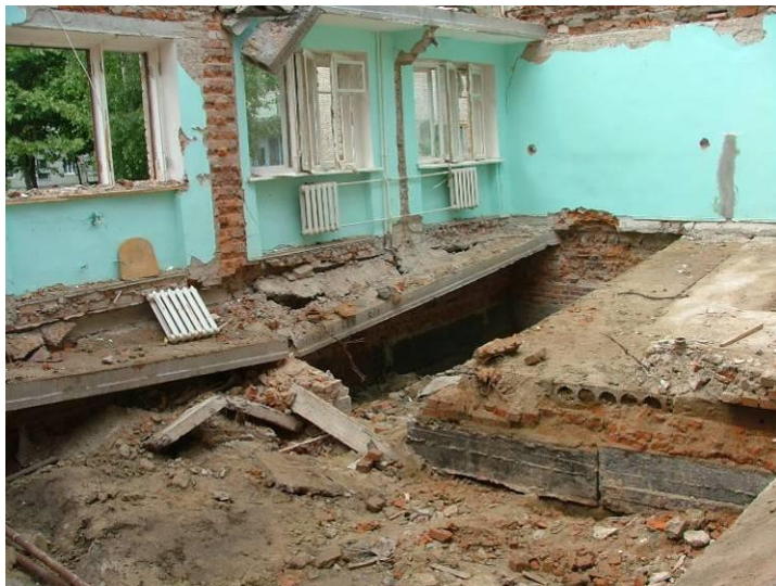
Рисунок 9.18 – Общий вид участка обрушения: разрушение поперечных стен, просадка фундаментов и плит перекрытия технического подполья
