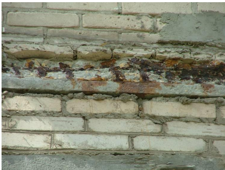
Рисунок 9.35 – Фрагмент опорной балки балконной плиты: пластинчатая коррозия стержней; непроектное положение коротышей
