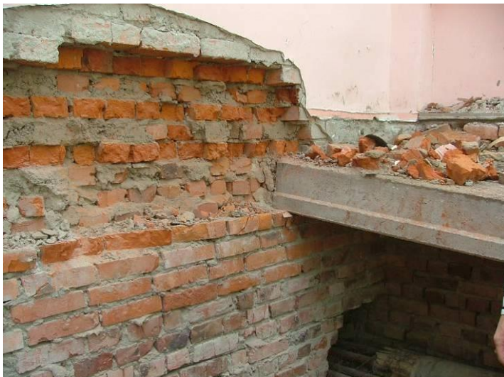
Рисунок 9.21 – Фрагмент участка перекрытия технического подполья: разрушение участка кладки; недостаточное опирание плиты перекрытия и ее смещение с поворотом
