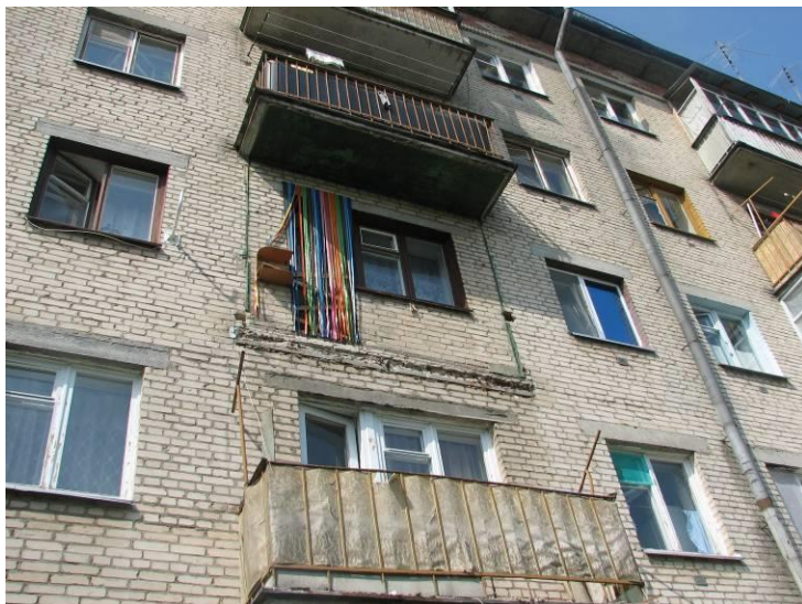
Рисунок 9.33 – Фрагмент обрушившегося участка
