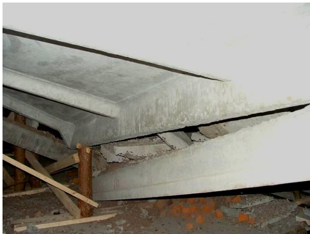
Рисунок 9.30 – Фрагмент обрушившегося участка покрытия: обрушение прогона, двух плит покрытия; обрушение и полное разрушение плиты покрытия
