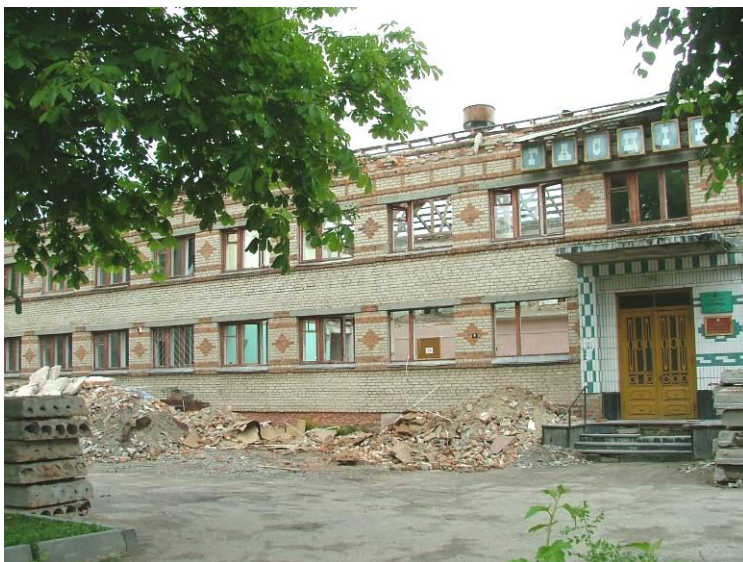
Рисунок 9.15 – Фрагмент главного фасада здания: обрушение участка крыши и отдельных конструкций
