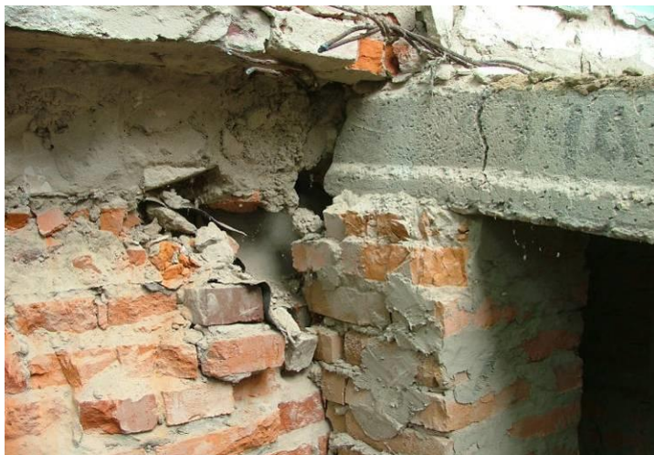
Рисунок 9.20 – Фрагмент участка перекрытия технического подполья: отрыв и смещение кирпичного столба с плитой перекрытия; излом плиты на опоре
