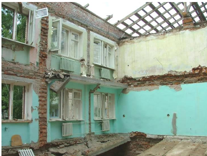
Рисунок 9.17 – Общий вид участка обрушения: обрушение и полное разрушение участков конструкций перекрытий и крыши, стен
