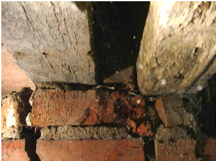
Рисунок 9.28 – Фрагмент участка опирания прогонов: отсутствие опорных подушек; разрушение и расслоение кладки под прогонами; смещение прогона
