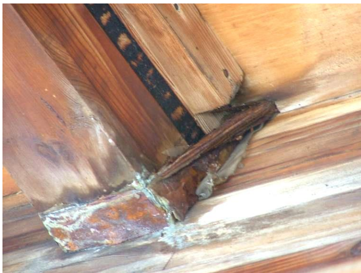
Рисунок 9.12 – Фрагмент крепления балки: переувлажнение балки в опоре; интенсивная коррозия и разрушение участка кронштейна
