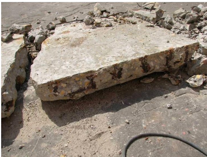
Рисунок 9.38 – Фрагмент балконной плиты: пластинчатая коррозия высокой интенсивности арматурных стержней на участке стыка тела балконной плиты с опорной балкой
