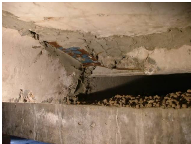
Рисунок 9.31 – Фрагмент обрушившегося участка:
