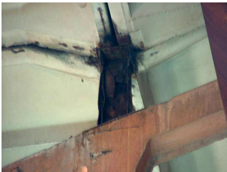
Рисунок 9.6 – Фрагмент стойки: пластинчатая коррозия двутавра и опорного столика значительной интенсивности; потеря устойчивости опорного столика
