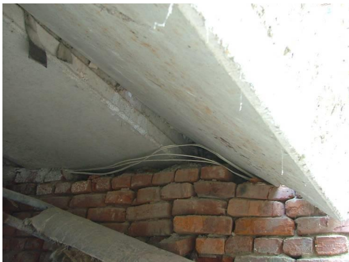
Рисунок 9.23 – Фрагмент участка перекрытия технического подполья: некачественная перевязка рядов кладки; отсутствие раствора на глубину до 80 мм; смещение плиты перекрытия
