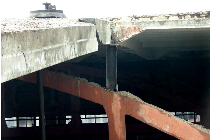
Рисунок 9.3 – Фрагмент поврежденного участка покрытия: обрушение двух крайних плит; излом плиты; полное разрушение опорного участка плиты; деформация стальной стойки
