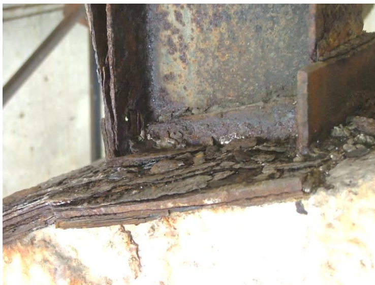
Рисунок 9.5 – Фрагмент опорной части стойки: пластинчатая коррозия двутавра и опорной пластины значительной степени интенсивности
