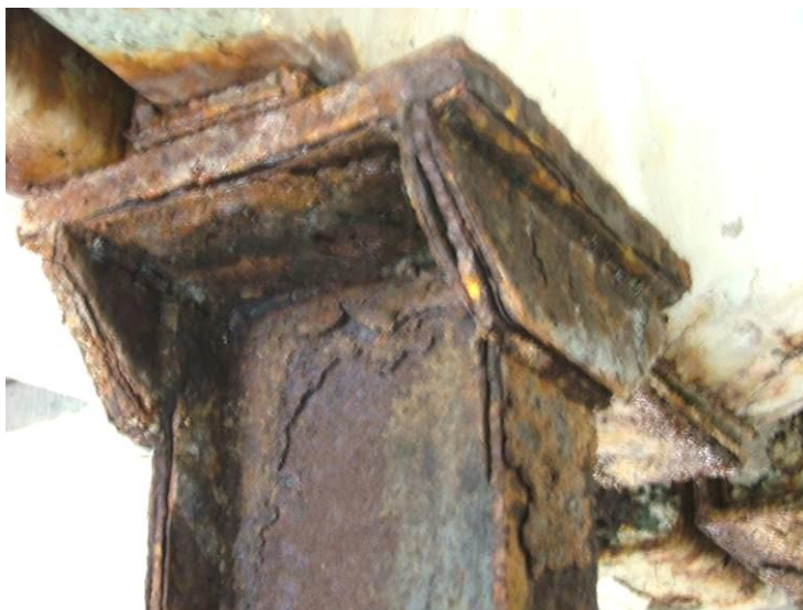
Рисунок 9.4 – Фрагмент оголовка стойки: пластинчатая коррозия опорного столика значительной степени интенсивности
