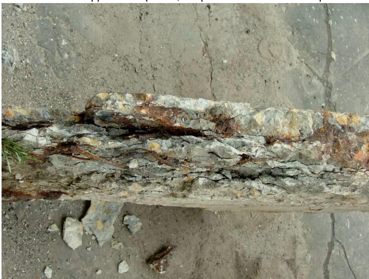
Рисунок 9.36 – Фрагмент балконной плиты: нарушение сцепления цементного камня с крупным заполнителем; полное разрушение и расслаивание бетона; пластинчатая коррозия арматурных стержней
