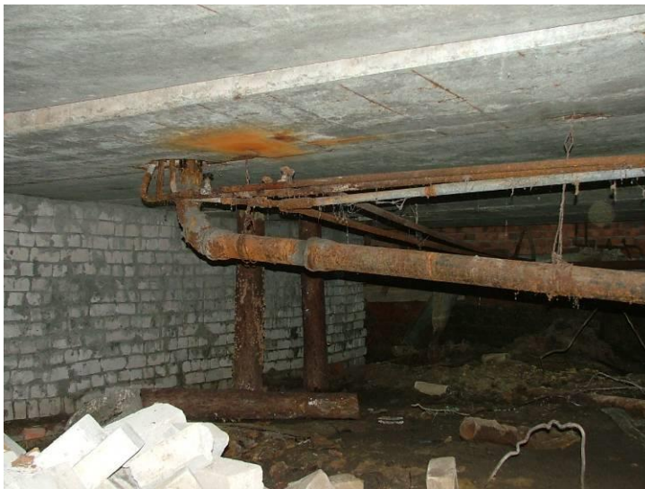
Рисунок 9.26 – Фрагмент конструкций технического подполья: отсутствие пола в подвальной части здания, наличие большого количества строительного и бытового мусора, грунта выше уровня пола; неудовлетворительное состояние водоотводящих систем
