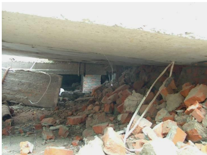
Рисунок 9.22 – Фрагмент участка перекрытия технического подполья: обрушение кладки; смещение плит перекрытия; выпадение отдельной плиты
