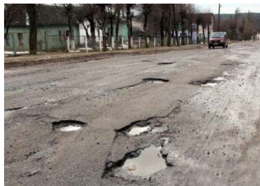
Рисунок 2 – Выбоины в дорожном покрытии
