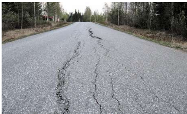
Рисунок 1 – Трещины в дорожном покрытии
