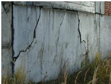
Многочисленные наклонные сквозные трещины до ширины раскрытия до 15 мм, выгиб панели относительно вертикальной оси на величину до 50 мм, разрушение панели на отдельных участках
