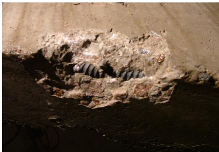
Условия эксплуатации – общественное здание. Срок эксплуатации – 32 года. Начало поверхностной коррозии стальной арматуры.
