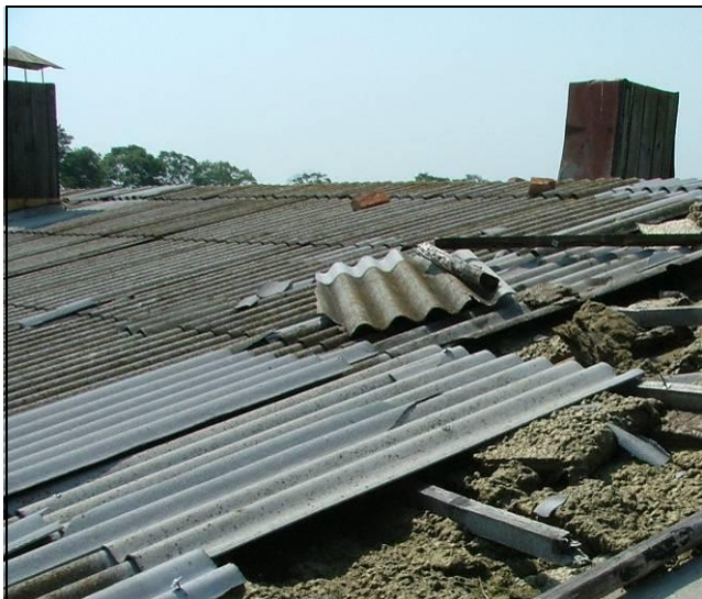
Рисунок 6.27 – Фрагмент кровли из асбестоцементных листов
