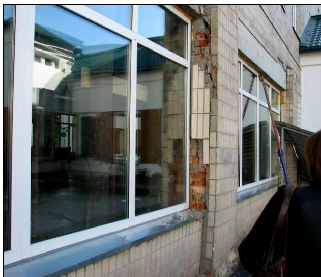
Рисунок 6.14 – Фрагмент простенка наружной кирпичной стены, облицованной керамической плиткой типа «кабанчик»
