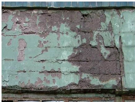
Размораживание и разрушение бетона защитного слоя на глубину до 20 мм на многочисленных участках, оголение и коррозия арматурных стержней высокой степени интенсивности на многочисленных участках
