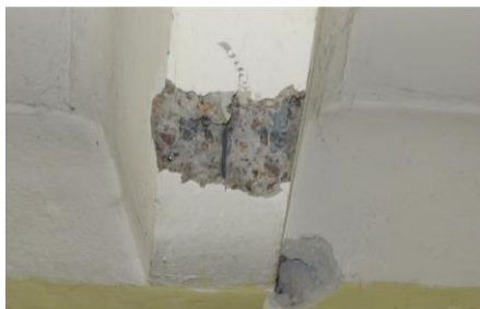
Условия эксплуатации – общественное здание. Срок эксплуатации – 42 года. Стальная арматура находится в пассивном состоянии
