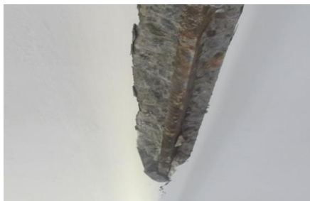
Условия эксплуатации – общественное здание. Срок эксплуатации – 24 года. Поверхностная коррозия стальной арматуры с уменьшением площади поперечного сечения на 20 %
