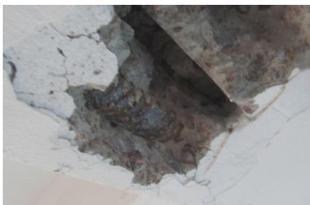
Условия эксплуатации – общественное здание. Срок эксплуатации – 53 года. Начало поверхностной коррозии стальной арматуры.
