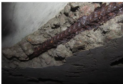
Условия эксплуатации – общественное здание. Срок эксплуатации – 34 года. Поверхностная коррозия стальной арматуры с уменьшением площади поперечного сечения на 25 %
