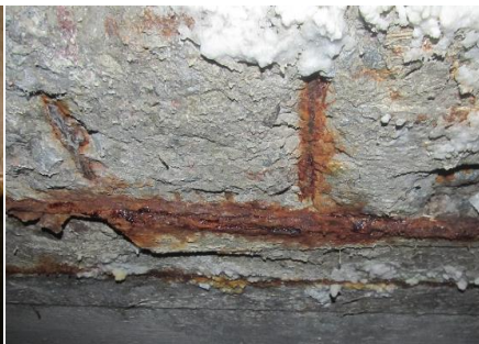
Условия эксплуатации – общественное здание. Срок эксплуатации – 18 лет. Поверхностная коррозия стальной арматуры с уменьшением площади поперечного сечения до 30 %
