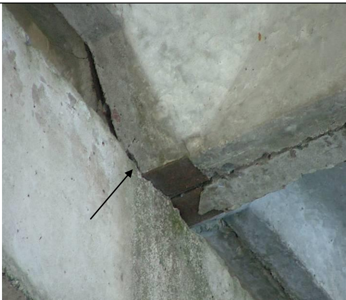
Недостаточная ширина опирания плит покрытия (до 30 мм)
