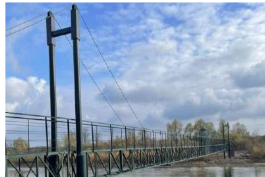
Рисунок 2 – Опасный участок моста через реку Горынь
