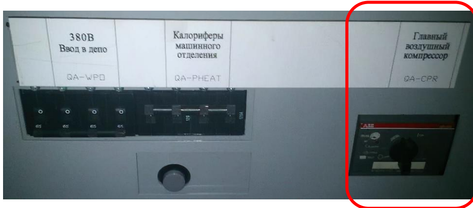
Рисунок 19.9 – Расположение автомата «Главный воздушный компрессор QA-CPR» на шкафу низковольтной аппаратуры
