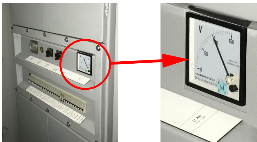
Рисунок 18.8 – Расположение вольтметра цепей управления «UАБ PV-BA» в шкафу МСУД
