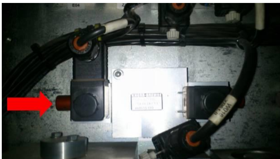
Рисунок 19.4 – Расположение кнопки аварийного отключения стояночного тормоза на шкафу тормозной аппаратуры
