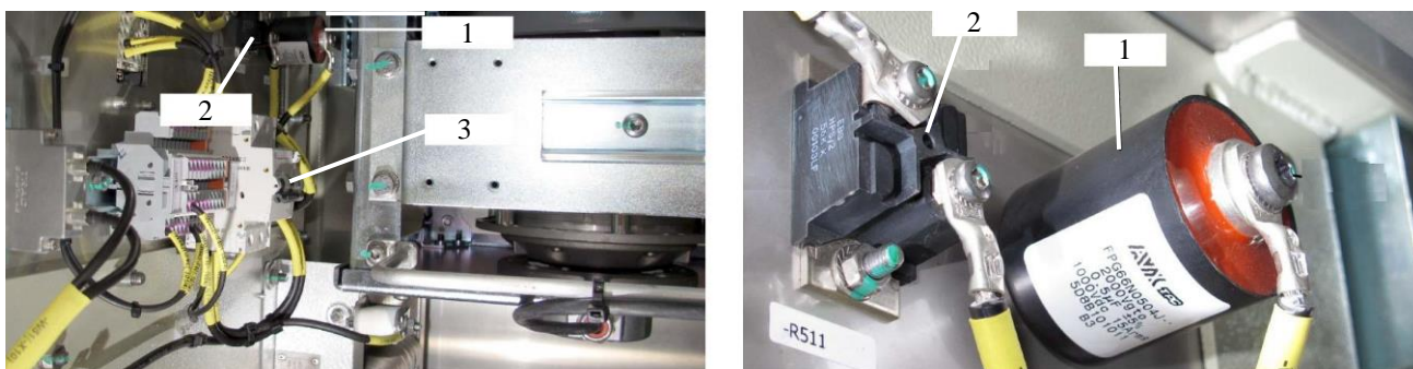
Рисунок 6.31 – Общий вид конденсатора и резистора системы защиты от короткого замыкания на землю:
