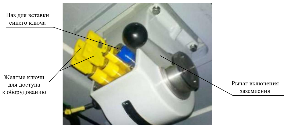
Рисунок 5.12 – Ключевой коммутатор крышевого заземлителя
