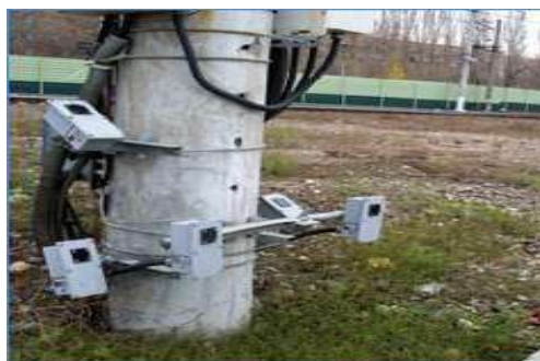
Рисунок 1 – Оснащение аппаратурой АСКО ПВ
