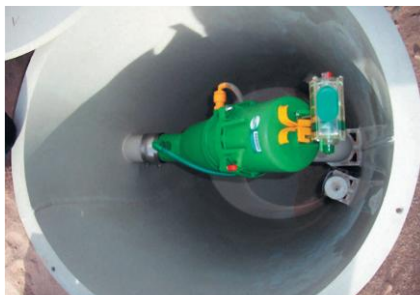
Рисунок 1.19 – Смотровой колодец со смонтированным вакуумным клапаном
