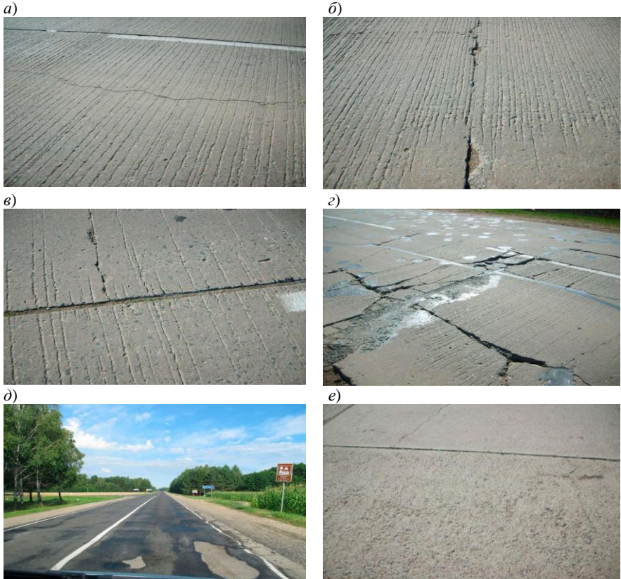
Рисунок 1.36 – Дефекты покрытия жестких дорожных одежд [25]:
