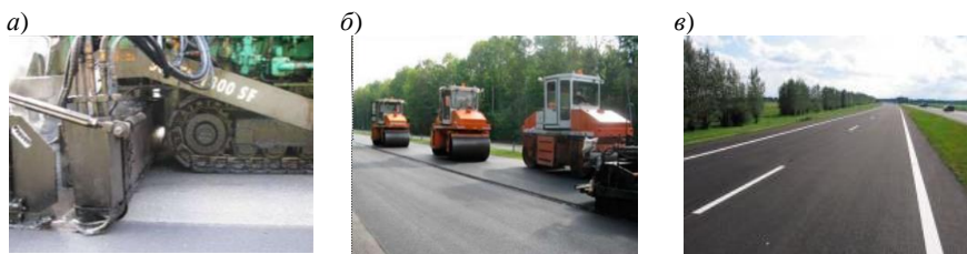
Рисунок 1.43 – Укладка тонкого фрикционного слоя асфальтоукладчиком (а), уплотнение фрикционного слоя (б), вид готового покрытия (в)
