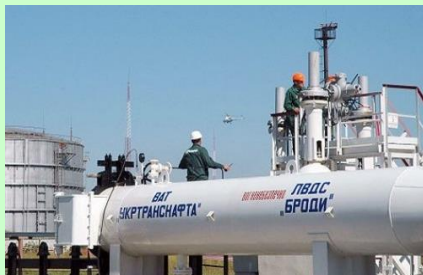
Рисунок 4.76 – Перекачивающая станция нефтепровода
