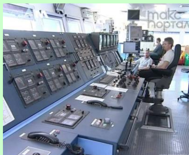
Рисунок 4.72 – Пункт управления газораспределительной станцией
