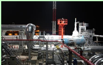
Рисунок 4.75 – Начальная станция нефтепровода
