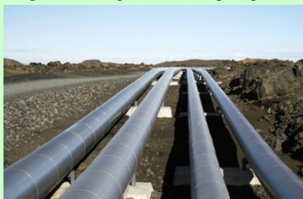
Рисунок 4.74 – Наземная прокладка нефтепровода
