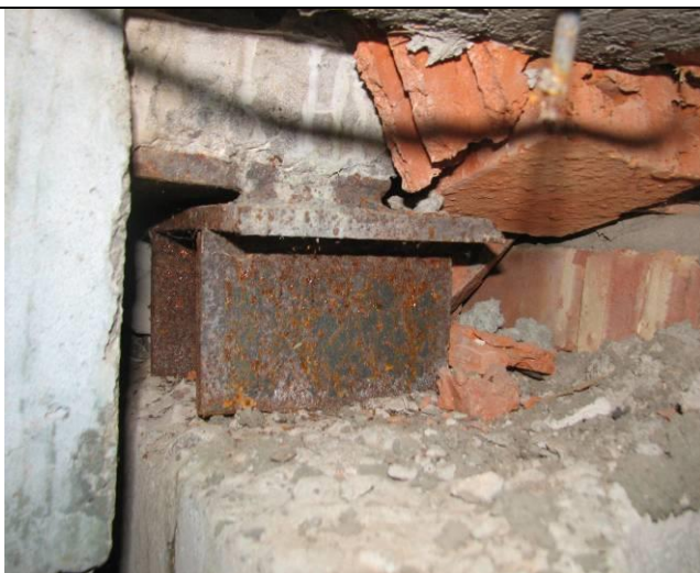
Рисунок А.51 – Фрагмент узла опирания ж/б ригеля на стену, выполненную из блоков ФБС
