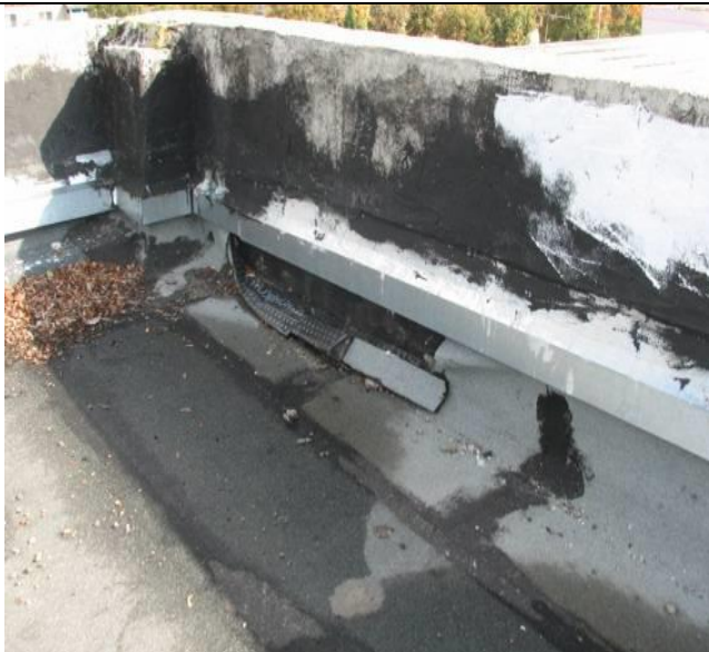
Некачественная приклейка верхнего слоя гидроизоляционного ковра к парапетной части наружной стены с последующим отслаиванием
