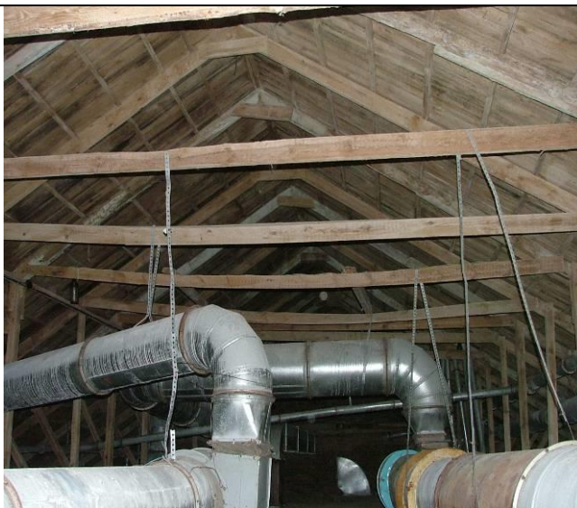
Закрепление за затяжки стропильной системы трубопроводов вентиляционной системы и как следствие, прогиб затяжек
