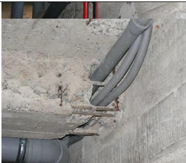
Механическое разрушение бетона балки в опорной зоне по всей толщине для пропуска коммуникаций
