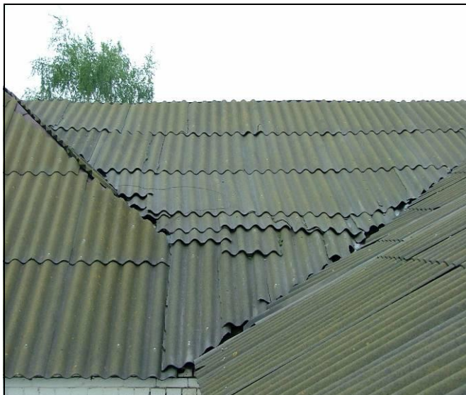
Рисунок А.94 – Фрагмент кровли из асбестоцементных листов
