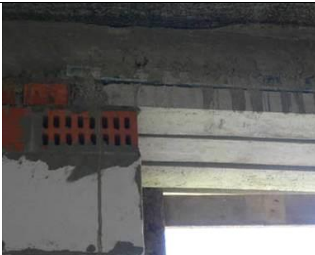
Укладка в опорной зоне перемычек кирпича керамического щелевого («на ребро»); недостаточная ширина опирания крайней перемычки (до 70 мм)
