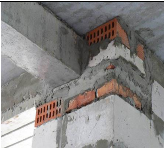
Некачественное выполнение кладки в опорной зоне прогона: применение различных материалов (кирпича керамического полнотелого и кирпича щелевого), укладка кирпича на ребро
