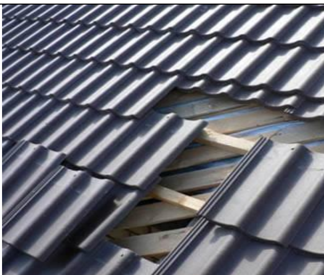
Крепление контробрезетки под углом к стропильным ногам; отсутствие вентиляционного зазора
