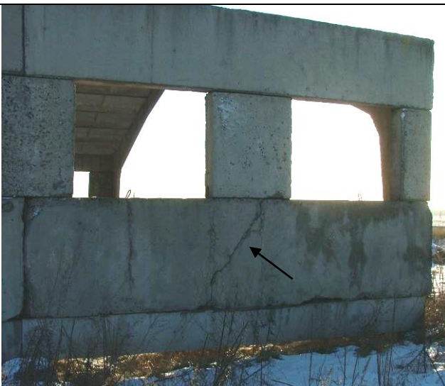
Применение стеновой панели в нижнем ряду с наклонной трещиной в средней части ширины раскрытия до 1,5 мм
