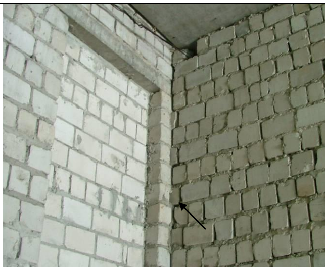
Некачественная перевязка рядов кладки внутренней несущей стены с наружной по всей высоте
