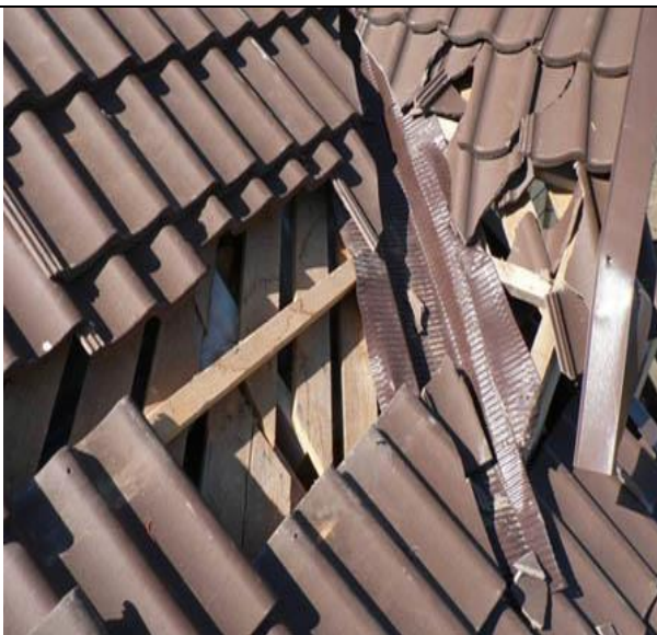
Отсутствие бруска опоры желобка; сплошного настила ендовы, крепления черепицы непосредственно у ендовы
