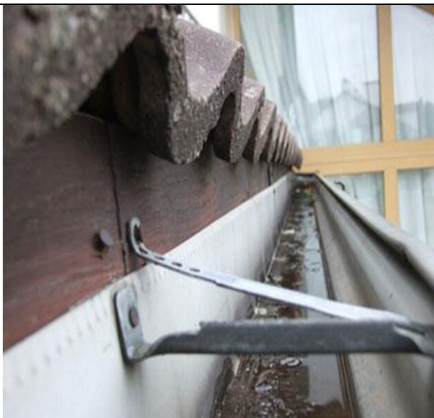
Недостаточный уклон желоба водоотвода с кровли и застаивание воды
