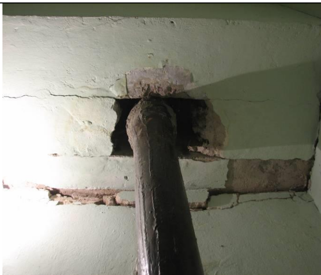
Механическое разрушение среднего прогона и пропуск через его тело трубы внутреннего водоотвода с кровли
