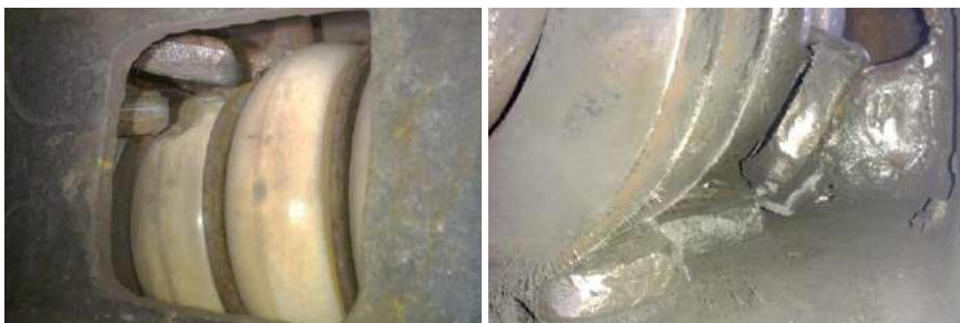
Рисунок 4 – Последствия разрушения пластин неподвижных
