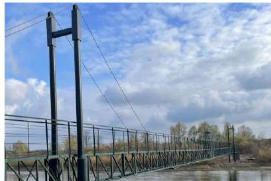
Рисунок 2 – Опасный участок моста через реку Горынь
