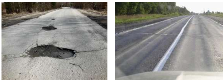
Рисунок 1 – Дефекты покрытий (ямы и колеиности)
