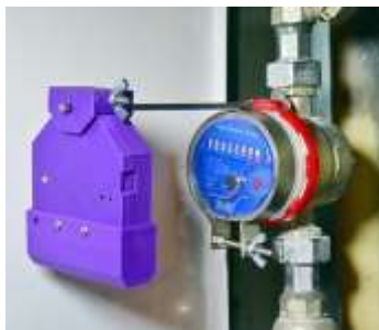
Рисунок 2 – Пример подключения у потребителя переносной расходомерной установки для поверки водосчетчиков
