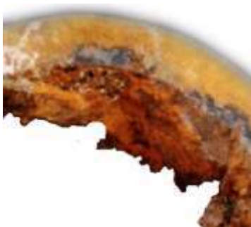
Рисунок 1 – Графитовая коррозия металлических труб
