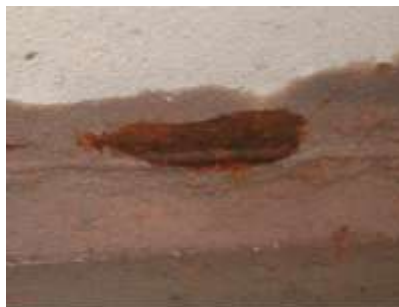
Рисунок 2 – Язвенная коррозия стальных водопроводных труб
