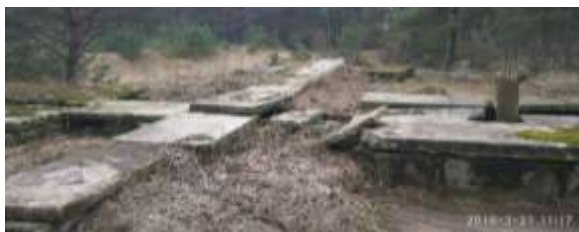
Рисунок 1 – Очистные сооружения в аг. Мосты Правые
