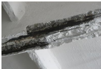
Рисунок 2 – Фрагмент продольных ребер плит покрытия Условия эксплуатации – сельскохозяйственное здание. Срок эксплуатации – 30 лет. Поверхностная коррозия стальной арматуры высокой степени интенсивности
