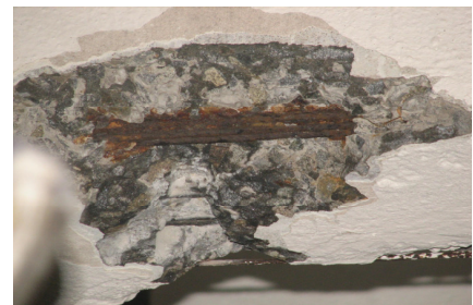
Рисунок 3 – Фрагмент балки покрытия Условия эксплуатации – промышленное здание. Срок эксплуатации – 25 лет. Пластинчатая коррозия стальной арматуры высокой степени интенсивности
