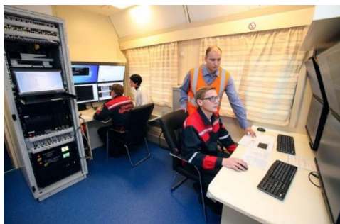
Рисунок 2.12 – Аппаратное помещение вагона-дефектоскопа
