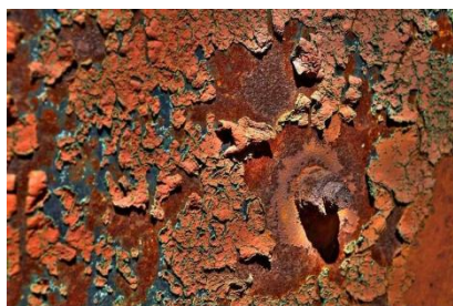
Рисунок 1 – Коррозия на металлических конструкциях
