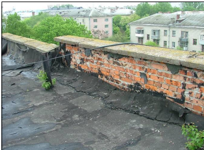
Рисунок В.18 – Фрагмент рулонной кровли на участке заведения на парапетную часть стены
