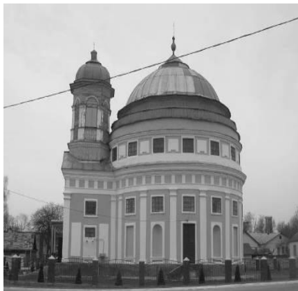
Рисунок 3 – Общий вид здания прихода храма Преображения Господня в г. Чечерск и фрагменты деревянных конструкций барабана и его обшивки, поврежденных дереворазрушающими грибами
