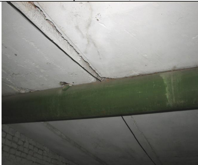
Опираие плит покрытия на прогон, выполненный из стальной трубы, с точечной передачей нагрузки вследствие круглого сечения прогона и отсутствием жесткого крепления плит к прогону
