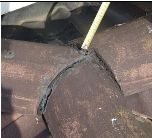
Нарушение герметичности узла примыкания коньковых элементов черепицы, отсутствие вальмовой черепицы
