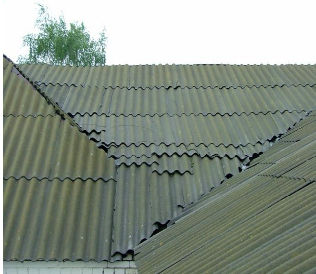
Применение фрагментов асбестоцементных листов на многочисленных участках, отсутствие в ендове доборного элемента (разжелобка); отсутствие доборных элементов в коньковой части
