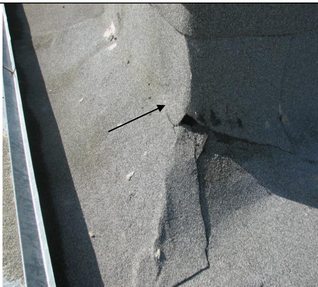
Некачественная приклейка верхнего слоя гидроизоляционного ковра на углу с образованием отверстия
