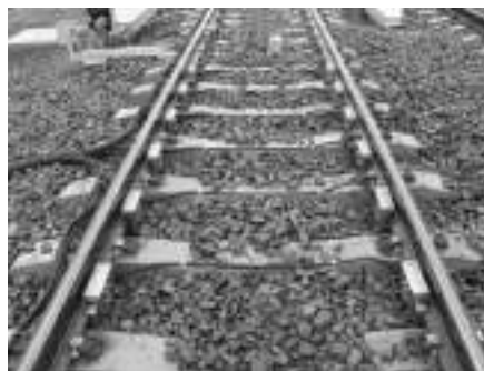
Рисунок 4 – Путевое оборудование комплекса WCM
