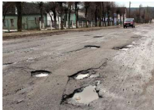
Рисунок 2 – Выбоины в дорожном покрытии
