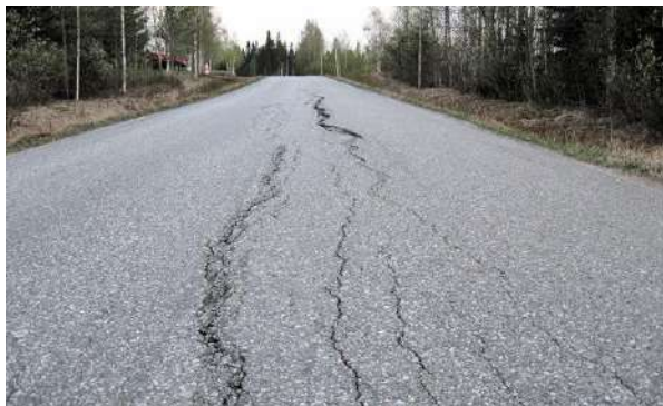
Рисунок 1 – Трещины в дорожном покрытии
