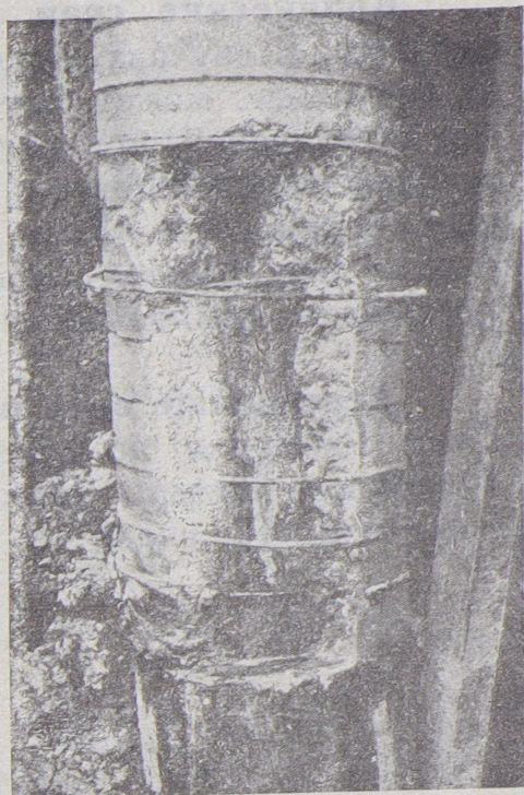
Фиг. 12. Составная свая с разбитым бетоном для осмотра у соединения с головкой деревянной сваи—отрыта после 665 ударов двухтонной бабы, давшая при пробной нагрузке в 50 т осадку меньше 1,25 см.
