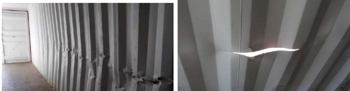
Рисунок 1 – Повреждения боковой стены контейнера
