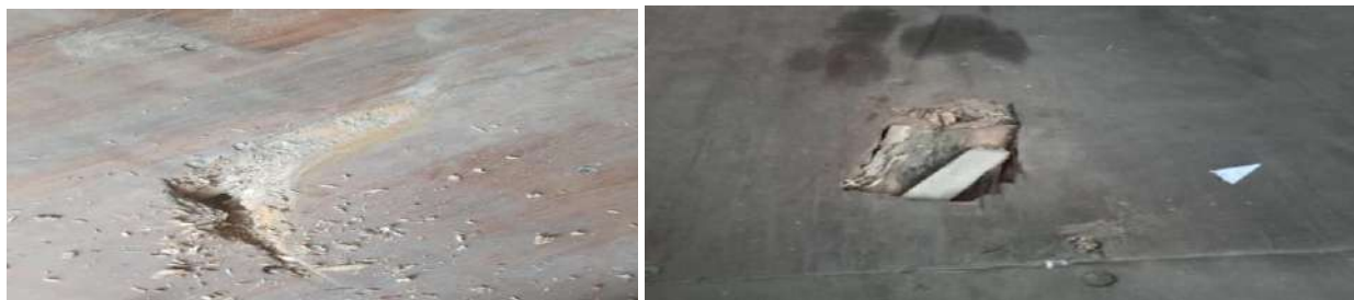
Рисунок 2 – Повреждения деревянного настила пола
