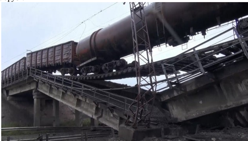
Рисунок 1 – Разрушение железнодорожного путепровода в ходе движения подвижного состава районе Новобахмутовки в Донецкой области
