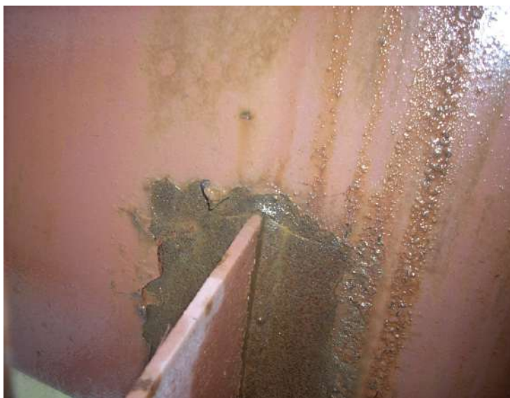
Рисунок 1 – Трещины в месте крепления воздухораспределителя к хребтовой балке
