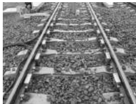
Рисунок 4 – Путевое оборудование комплекса WCM
