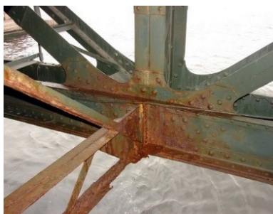
Рисунок 2 – Коррозия в узле фермы железнодорожного моста
