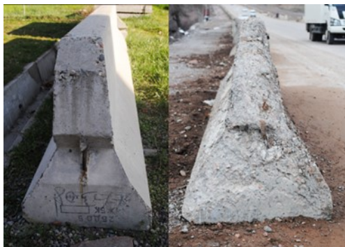
Рисунок 1 – Фрагменты блоков ограждения до и после разрушения
