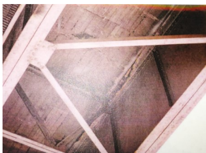
Рисунок 1 – Коррозия верхнего пояса балки пролетного строения автодорожного моста через р. Белую в г. Уфе
