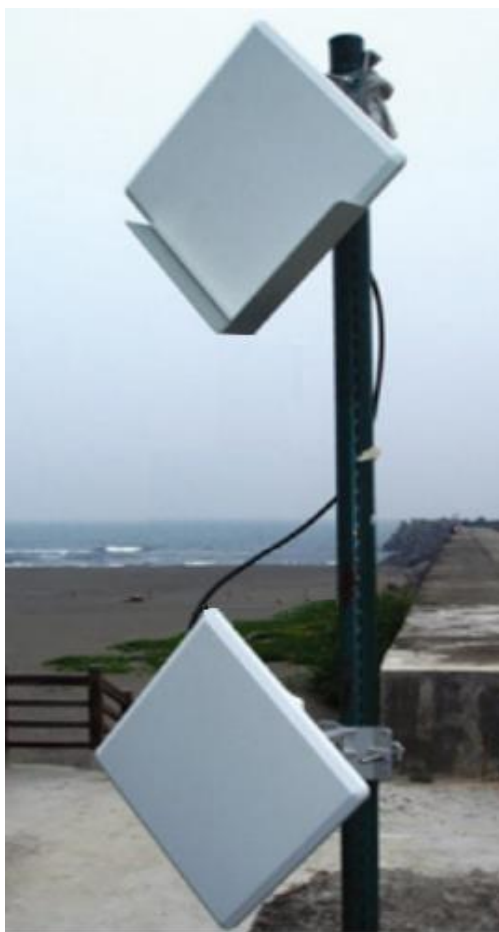
Рисунок 2 – Точки доступа D-Link DAP-3760/3860, установленные на трубостойке
