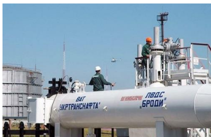
Рисунок 5.74 – Перекачивающая станция нефтепровода
