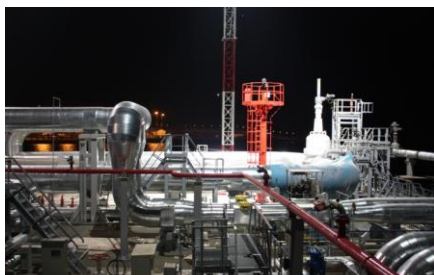
Рисунок 5.73 – Начальная станция нефтепровода
