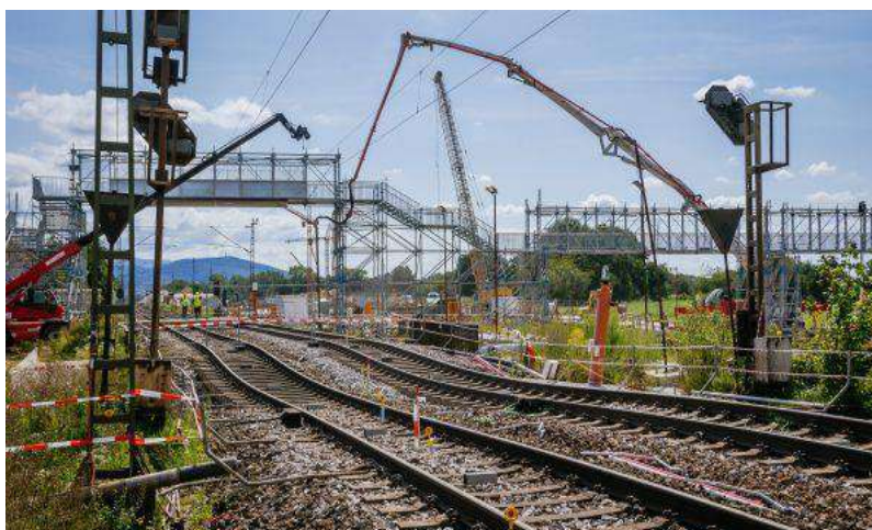
Рисунок 1 – Последствия разрушения туннеля вблизи города Раштатт
