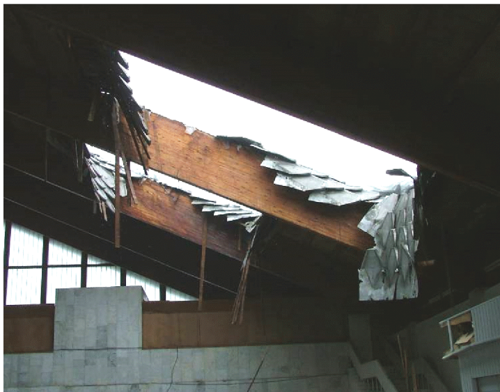
Рисунок 7.9 – Фрагмент участка обрушения (вид снизу): обрушение и полное разрушение двух участков покрытия
