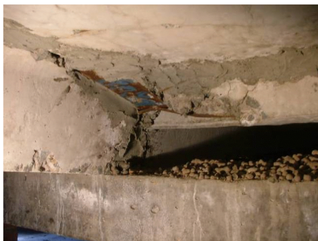
Рисунок 7.31 – Фрагмент обрушившегося участка: разрушение опорной зоны плит покрытия (излом продольного ребра), следы ремонта плит в процессе эксплуатации (заделка трещин раствором)
