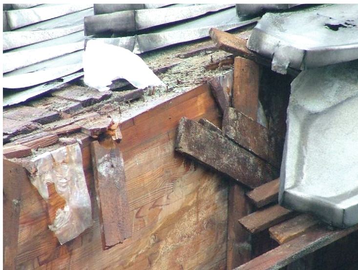
Рисунок 7.10 – Фрагмент покрытия на участке обрушения (вид сверху): разрушение кронштейнов и срез балок
