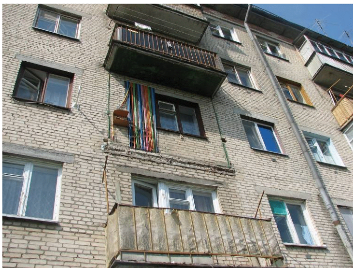
Рисунок 7.33 – Фрагмент обрушившегося участка
