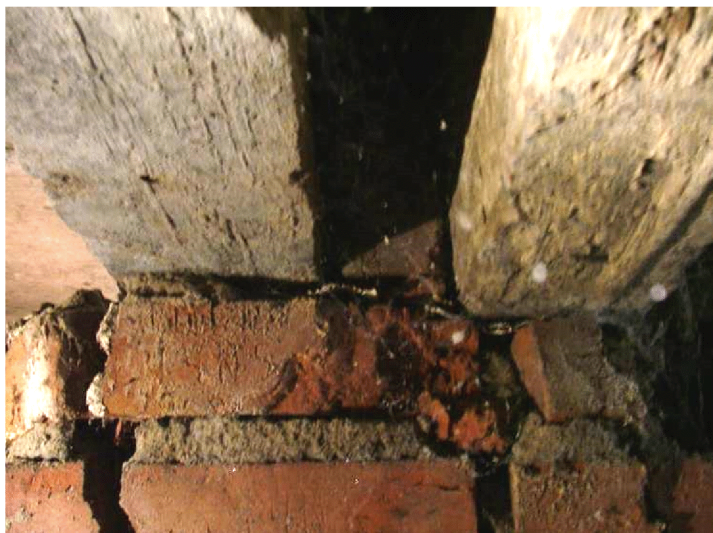
Рисунок 7.28 – Фрагмент участка опирания прогонов: отсутствие опорных подушек; разрушение и расслоение кладки под прогонами; смещение прогона
