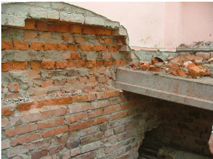
Рисунок 7.21 – Фрагмент участка перекрытия технического подполья: разрушение участка кладки; недостаточное опирание плиты перекрытия и ее смещение с поворотом
