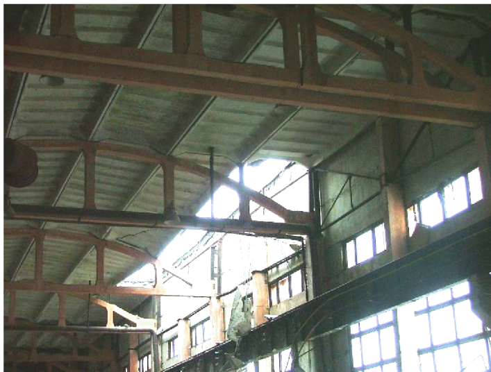
Рисунок 7.1 – Фрагмент общего вида цеха изнутри на участке обрушения: обрушение и полное разрушение двух крайних плит покрытия
