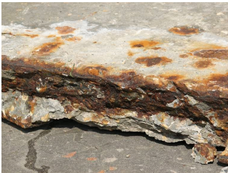
Рисунок 7.37 – Фрагмент балконной плиты: полное разрушение арматурных стержней коррозией
