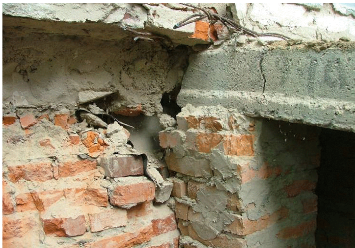
Рисунок 7.20 – Фрагмент участка перекрытия технического подполья: отрыв и смещение кирпичного столба с плитой перекрытия; излом плиты на опоре
