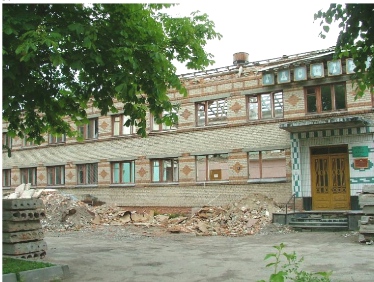
Рисунок 7.15 – Фрагмент главного фасада здания: обрушение участка крыши и отдельных конструкций
