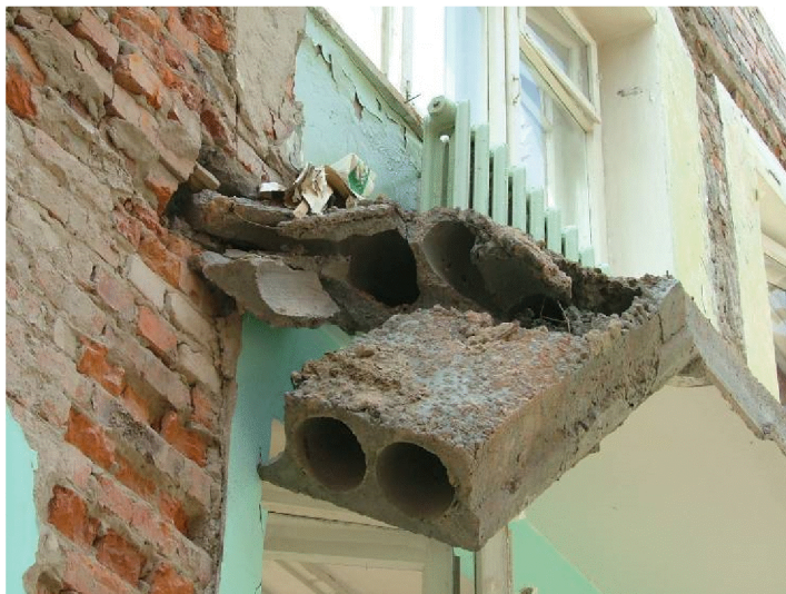
Рисунок 7.19 – Общий вид участка обрушения: излом и полное разрушение отдельного участка плиты
