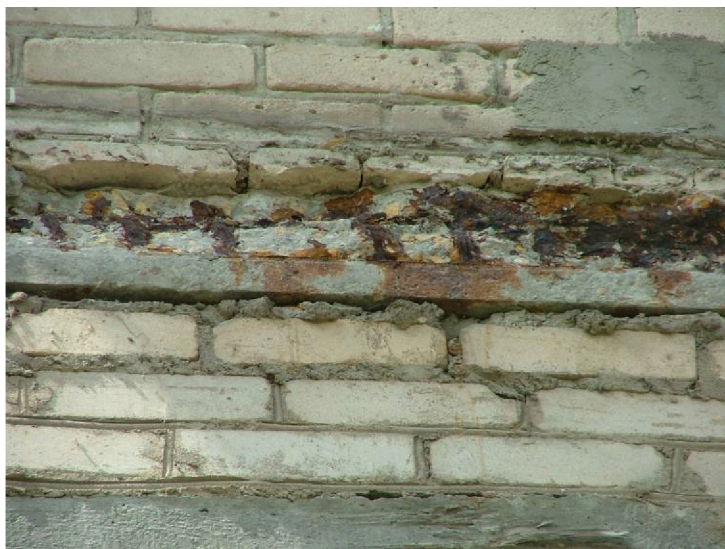
Рисунок 7.35 – Фрагмент опорной балки балконной плиты: пластинчатая коррозия стержней; непроектное положение коротышей
