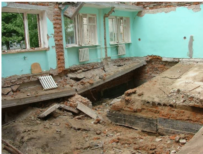
Рисунок 7.18 – Общий вид участка обрушения: разрушение поперечных стен, просадка фундаментов и плит перекрытия технического подполья
