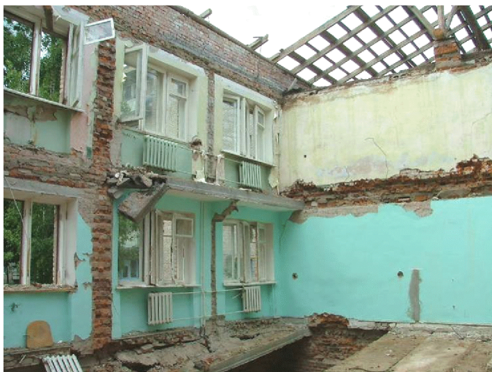
Рисунок 7.17 – Общий вид участка обрушения: обрушение и полное разрушение участков конструкций перекрытий и крыши, стен
