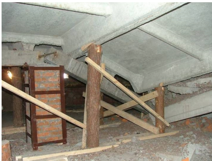
Рисунок 7.29 – Фрагмент обрушившегося участка покрытия: разрушение кирпичного столба; обрушение прогона и двух плит покрытия
