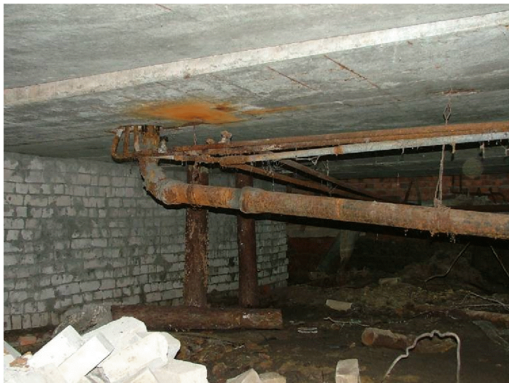
Рисунок 7.26 – Фрагмент конструкций технического подполья: отсутствие пола в подвальной части здания, наличие большого количества строительного и бытового мусора, грунта выше уровня пола; неудовлетворительное состояние водоотводящих систем
