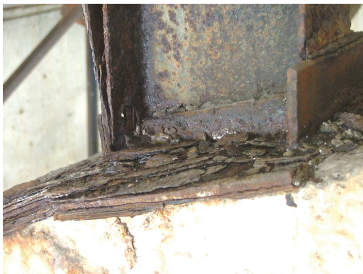
Рисунок 7.5 – Фрагмент опорной части стойки: пластинчатая коррозия двутавра и опорной пластины значительной степени интенсивности
