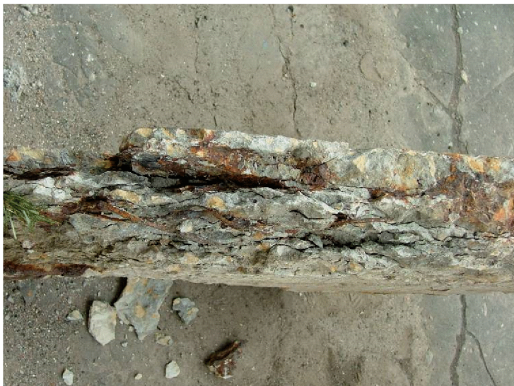
Рисунок 7.36 – Фрагмент балконной плиты: нарушение сцепления цементного камня с крупным заполнителем; полное разрушение и расслаивание бетона; пластинчатая коррозия арматурных стержней
