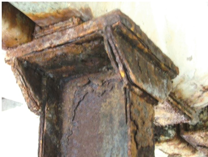
Рисунок 7.4 – Фрагмент оголовка стойки: пластинчатая коррозия опорного столика значительной степени интенсивности
