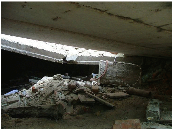
Рисунок 7.24 – Фрагмент участка перекрытия технического подполья: смещение плит; излом и разрушение участка плиты перекрытия
