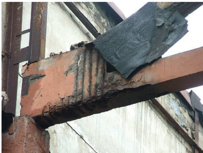
Рисунок 7.2 – Фрагмент участка опирания фермы: оголение и пластинчатая коррозия хомутов; отдельных участков конструктивной и рабочей арматуры; разрушение бетона защитного слоя
