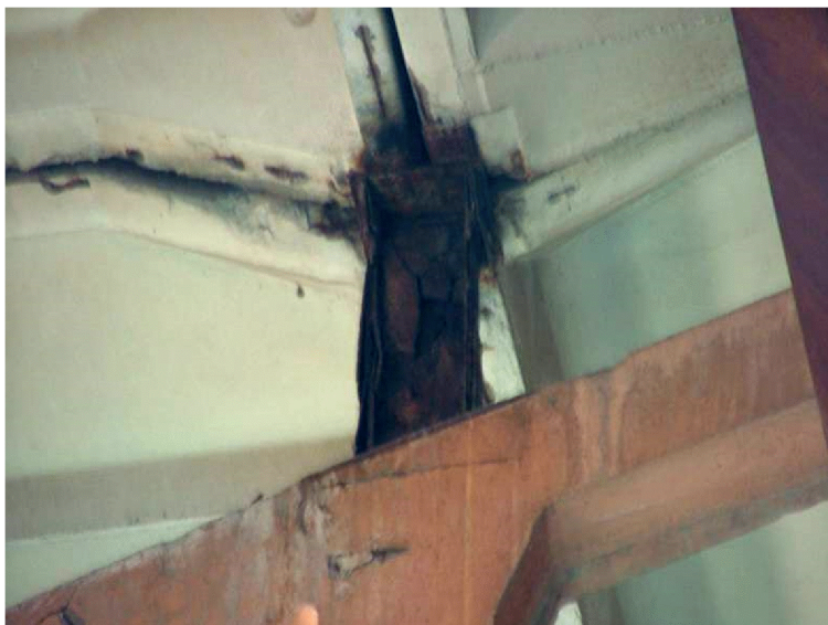
Рисунок 7.6 – Фрагмент стойки: пластинчатая коррозия двутавра и опорного столика значительной интенсивности; потеря устойчивости опорного столика
