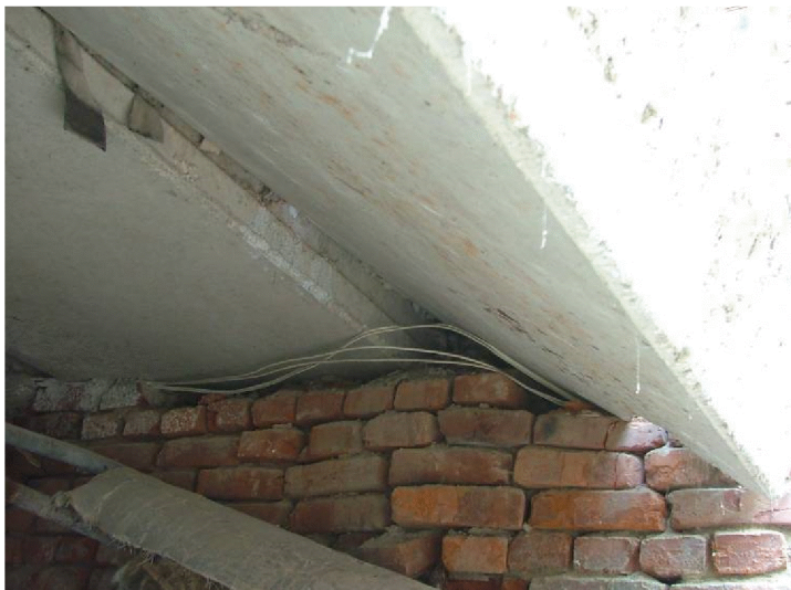
Рисунок 7.23 – Фрагмент участка перекрытия технического подполья: некачественная перевязка рядов кладки; отсутствие раствора на глубину до 80 мм; смещение плиты перекрытия
