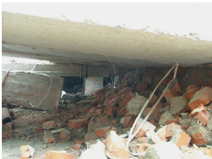
Рисунок 7.22 – Фрагмент участка перекрытия технического подполья: обрушение кладки; смещение плит перекрытия; выпадение отдельной плиты
