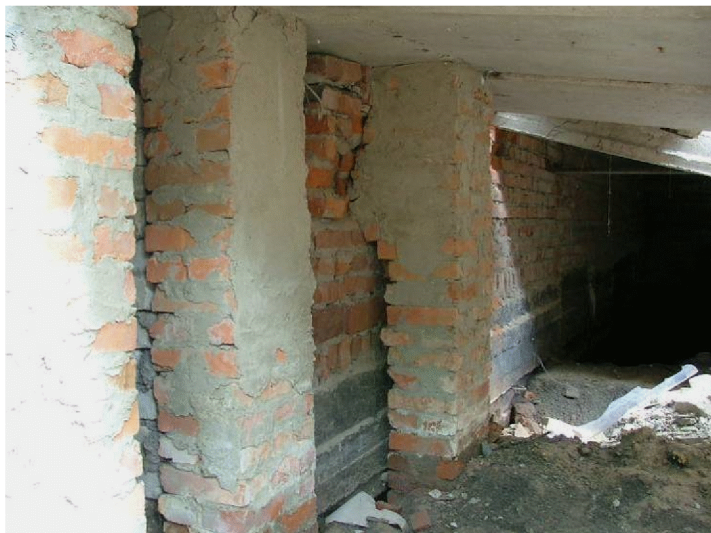
Рисунок 7.25 – Дополнительные столбы из кирпича керамического полнотелого: отсутствие анкеровки столбов к стенам
