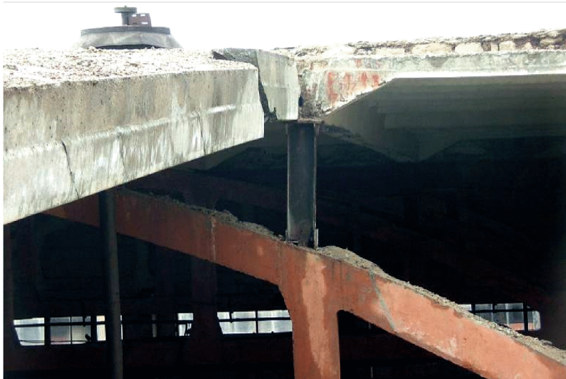
Рисунок 7.3 – Фрагмент поврежденного участка покрытия: обрушение двух крайних плит; излом плиты; полное разрушение опорного участка плиты; деформация стальной стойки
