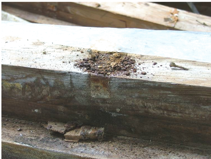
Рисунок 7.13 – Фрагмент балки покрытия и разрушенного коррозией участка обвязки
