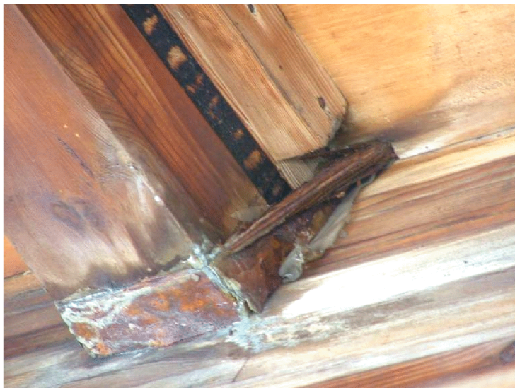
Рисунок 7.12 – Фрагмент крепления балки: переувлажнение балки в опоре; интенсивная коррозия и разрушение участка кронштейна
