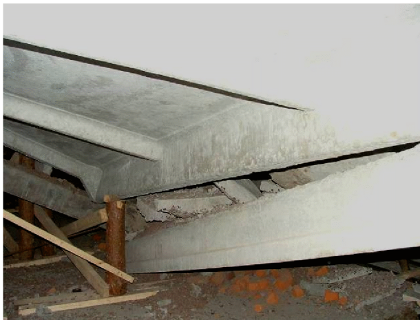
Рисунок 7.30 – Фрагмент обрушившегося участка покрытия: обрушение прогона, двух плит покрытия; обрушение и полное разрушение плиты покрытия
