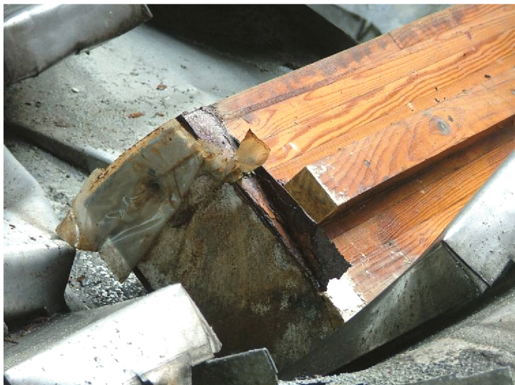
Рисунок 7.11 – Фрагмент балки покрытия: интенсивная коррозия и полное разрушение кронштейна
