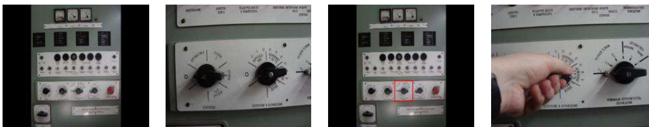
Рисунок 3 – Фрагменты фильма «Электрический щит вагона 47 К/к»
