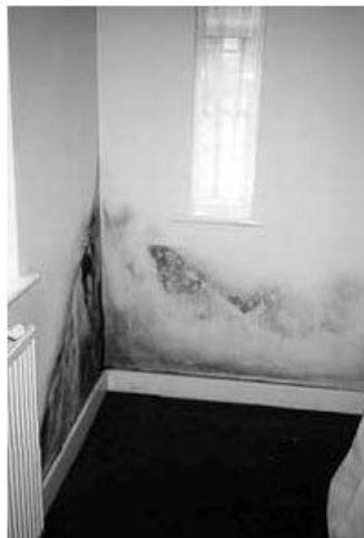
Рисунок 18 – Гнили мокрых конструкций
