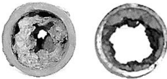
Рисунок 1 – Внутренние отложения труб
