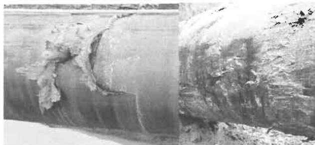
Рисунок 3 – Нарушение изоляции трубопровода при нарушенной геометрии ствола скважины
