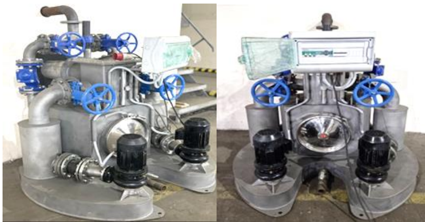
Рисунок 1 – Канализационная насосная станция
