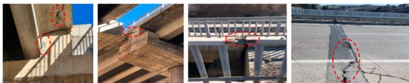
Рисунок 2 – Повреждение моста Адьяман Аксу
