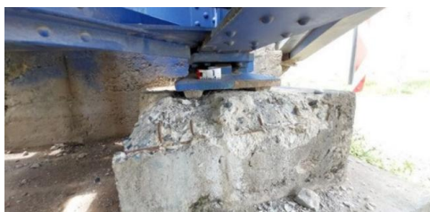
Рисунок 4 – Вид на поврежденную опору железнодорожного моста
