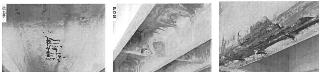
Рисунок 1 – Коррозионные повреждения железобетонных пролетных строений
