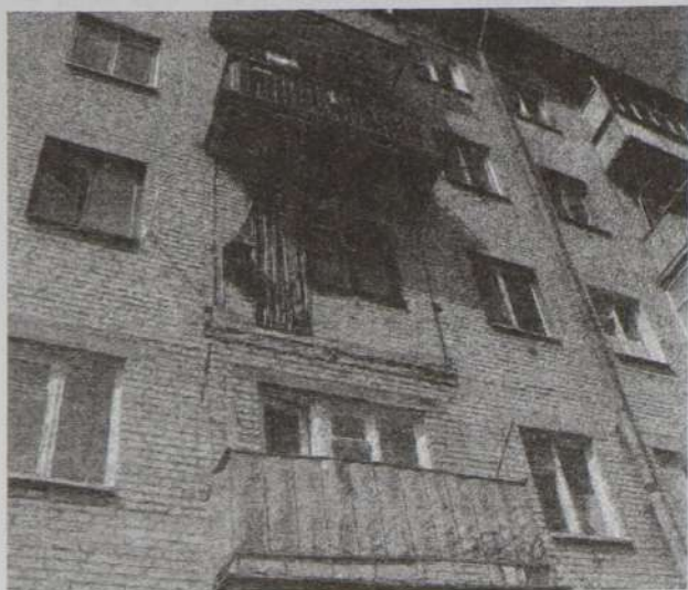
Рисунок 2 – Фрагмент обрушившегося участка
